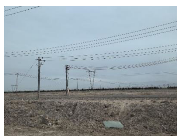
园艺 110kV 变电站西南侧
