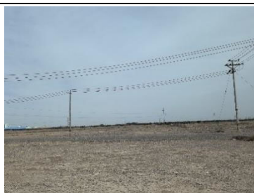
园艺 110kV 变电站东南侧
