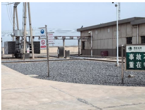
本期主变扩建位置
