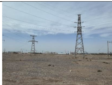
园艺 110kV 变电站西北侧
